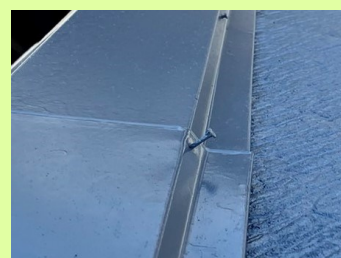
↑釘が浮いている
